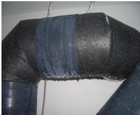
Abbildung 40: Kondensatbildung an einer geschäumten Luftleitung in einer Reihenhausanlage (Leitzinger, 2013)
