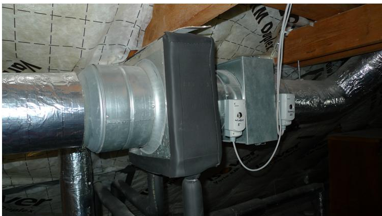
Abbildung 37: Heizregister statt Kühlregister verbaut – fehlender Kondensatablauf (Leitzinger, 2013)
