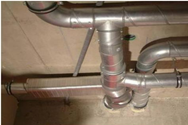
Abbildung 29: Problematische Kreuzung von Luftleitungen (Quelle: leit-wolf Luftkomfort)
