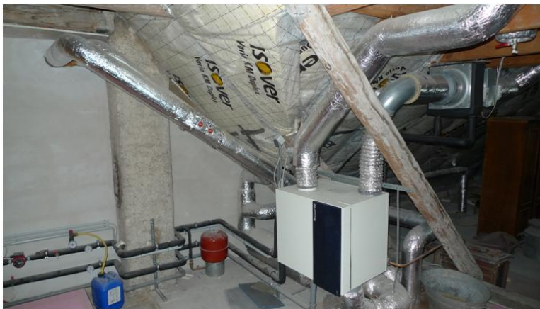
Abbildung 36: Lüftungsinstallation im nicht konditionierten Dachboden (Leitzinger, 2013)
