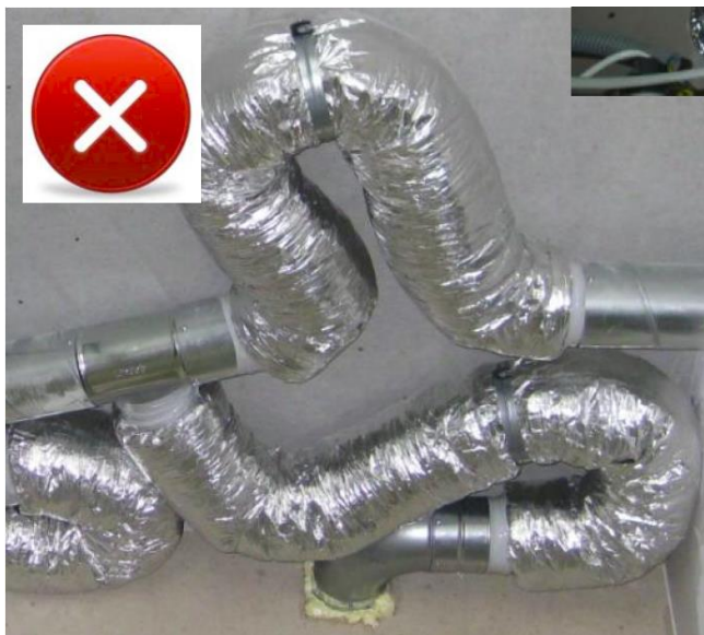
Abbildung 21: Beispiel eines nicht reinigbaren Leitungssystems in einer Zwischendecke (Leitzinger, 2013)
