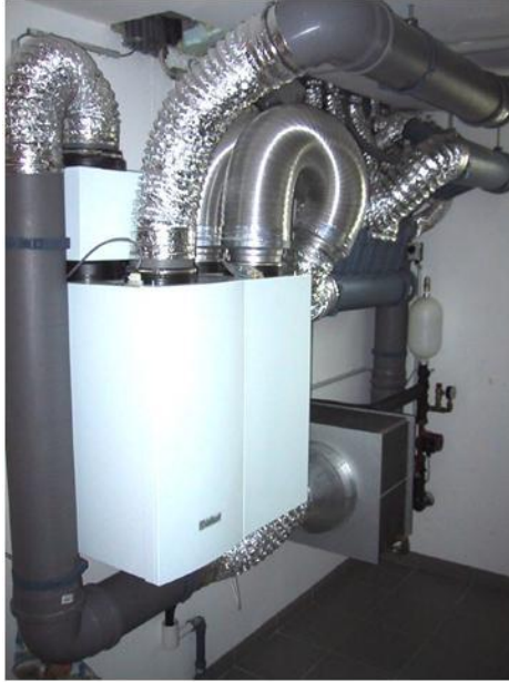
Abbildung 42: hochflexible, undämmbare Außenluft- und Fortluftleitungen in einem Einfamilienhaus (Leitzinger, 2013)
