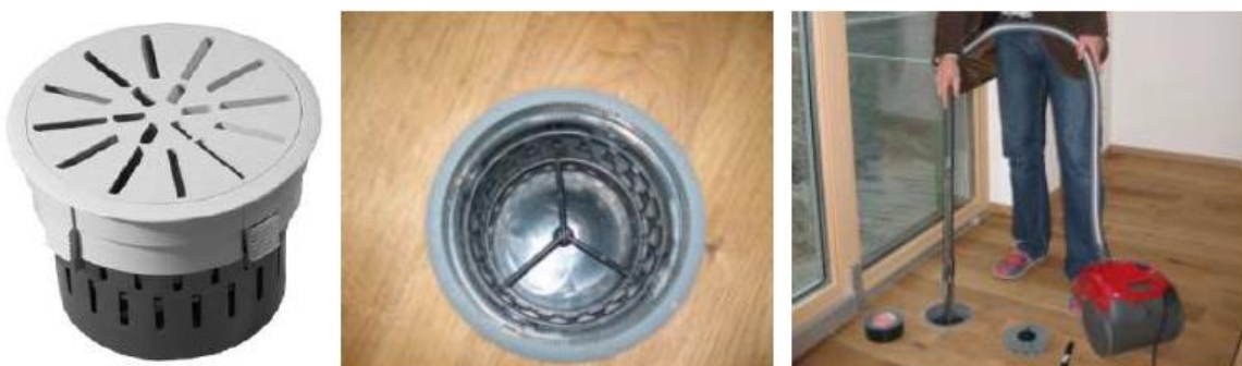
Abb. 3-51a; b; c: Fußbodenauslass (Quelle Systemair); Auslass mit verlegtem Boden; Reinigung des Bodenauslasses im Zuge der Luftmengen-Einmessung
