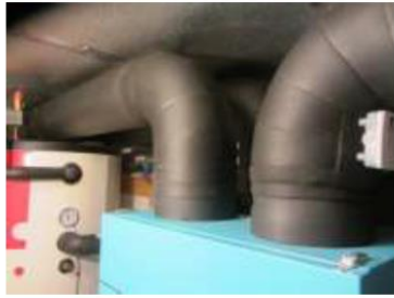
Abb. 3-47: Gedämmtes Außen- und Abluft Rohr mit lückenlosem Dämm-Anschluss am Gerät im „kalten Technikraum“
