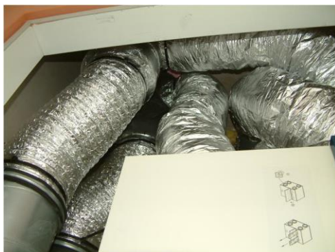
Abbildung 41: undämmbare hochflexible Außenluft- und Fortluftleitungen (links) in einem engen Haustechnikschacht in einer kleinen Wohnhausanlage (Leitzinger, 2013)
