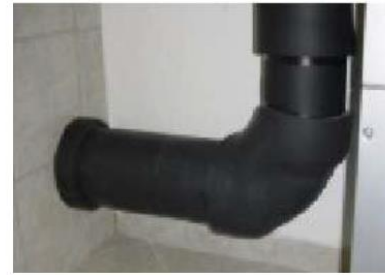
Abb. 3-46: : Gedämmte Außenluft Leitung im kalten Technikraum mit EWT Gefälle Richtung Wartungsschacht im Freien
