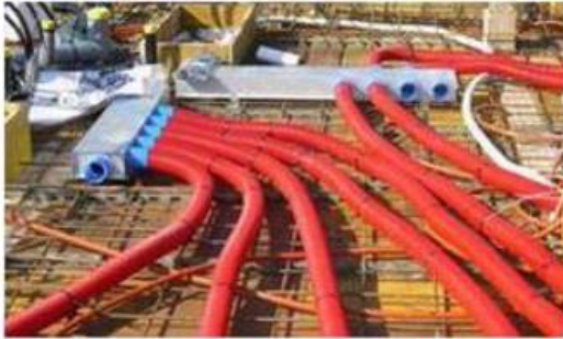
Flexible Luftleitungen in der Betondecke (Quelle: Nilan)
