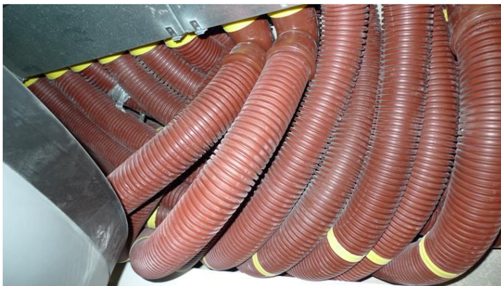
Abbildung 44: große Schlauchbündel nach Verteilbox (Leitzinger, 2013)
