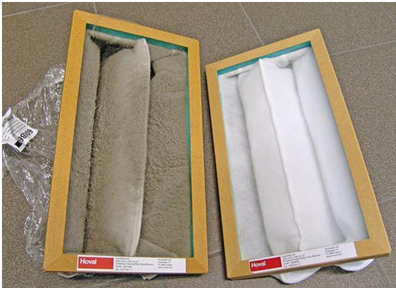
Abbildung 14: Abluftfilter einer Wohnraumlüftung links nach einem Jahr, rechts neu Quelle: www.bonit.at/wordpress/?p=2407
