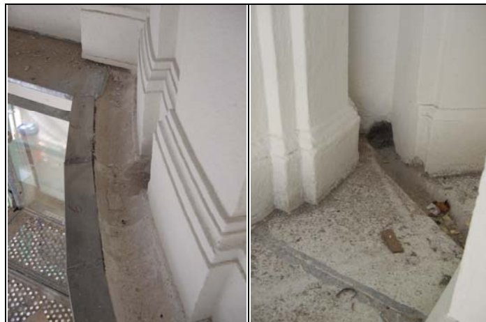
Abb. 17: Entwässerungsrinnen von Balkonen
