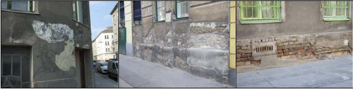
Abb. 7: Feuchtigkeitsschäden an Putzen in der Sockelzone
