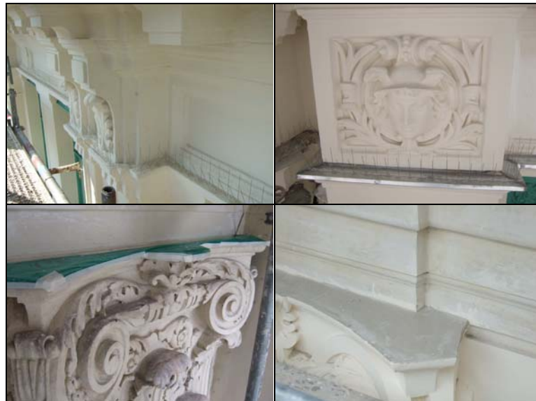
Abb. 8: oben links: kleiner Gesimsevorsprung verputzt, ohne Verblechung oben rechts: Gesimseverblechung mit Taubenabwehrspitzen unten links: Gesimseverblechung im Zuge Fassadensanierung neu ausgeführt unten rechts: neuer Glattstrich mit Gefälle nach außen
