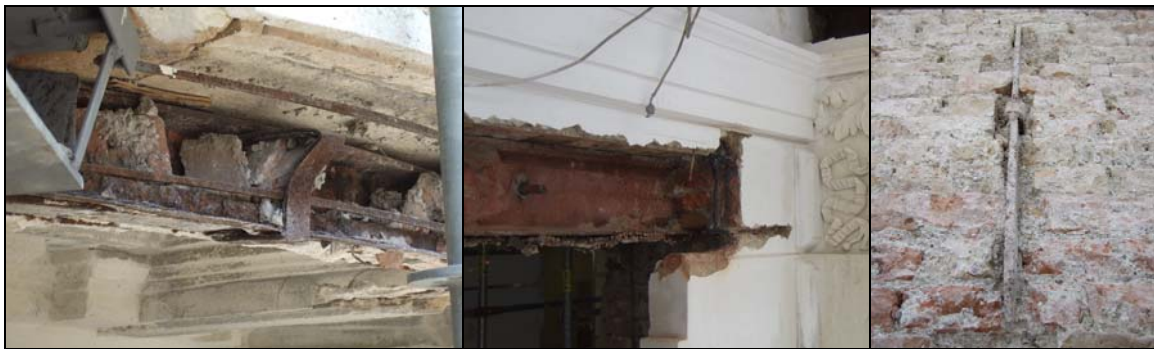
Abb. 2: Bild links: historische Stahlunterkonstruktion angerostet Bild Mitte: Stahlträger, Bild rechts: historische DeckenschlieÙe
