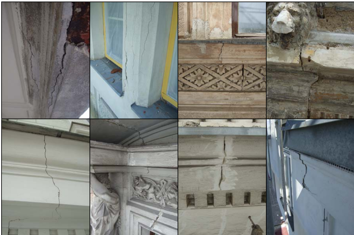
Abb. 5: Risse im Putzgrund
