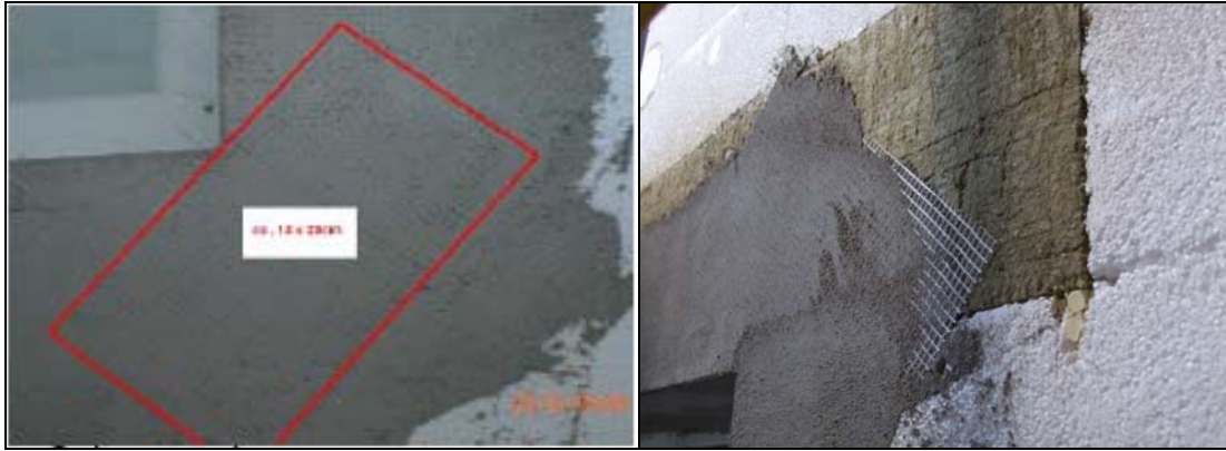
Abb. 21: Größe der Bewehrungsstreifen nicht eingehalten
