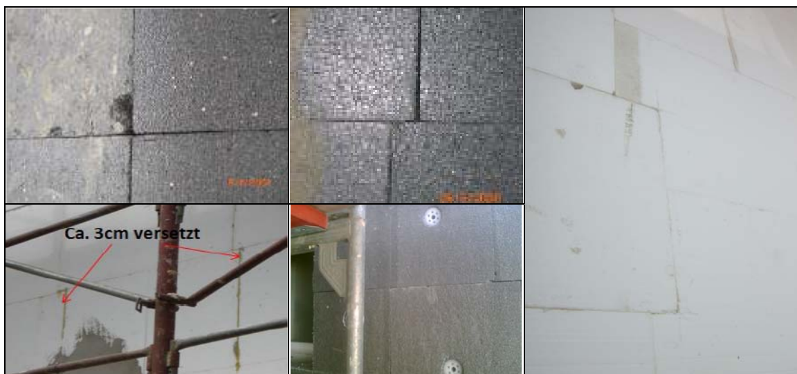
Abb. 10: Kreuzfugen, nicht voll auf Fuge verlegte Dämmplatten
