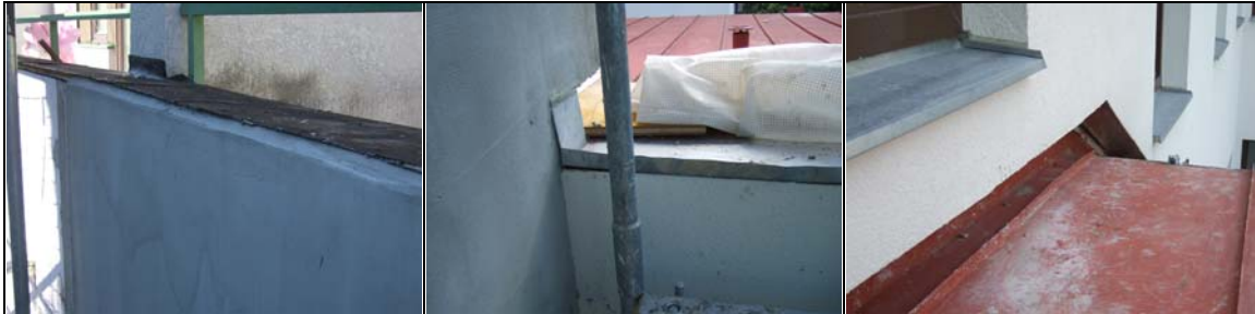
Abb. 4: links: Attikaunterkonstruktion wurde nicht an die neue Wärmedämmung angepasst; Mitte: Verblechungsanschluss direkt auf Wärmedämmung ohne (Holz-) Unterkonstruktion; rechts: alte Verblechung wurde nicht angepasst → Kältebrücke
