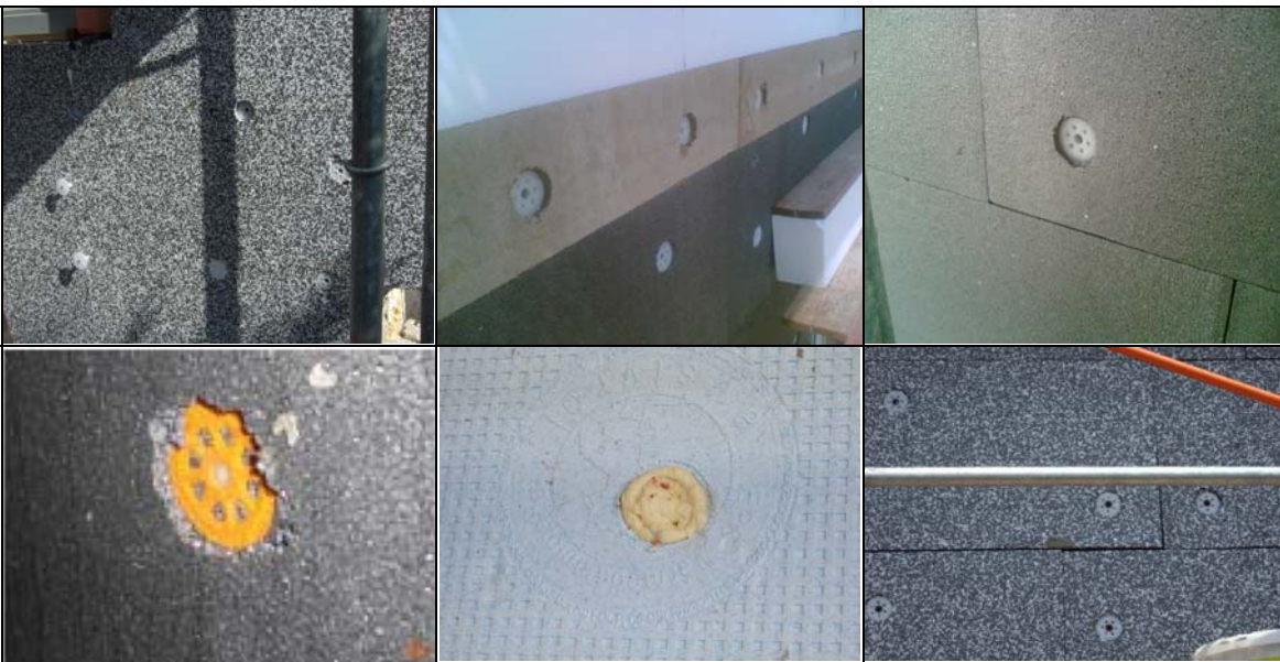
Abb. 18: zu tief sitzende Dübeln, teilweise ausgeschäumt
