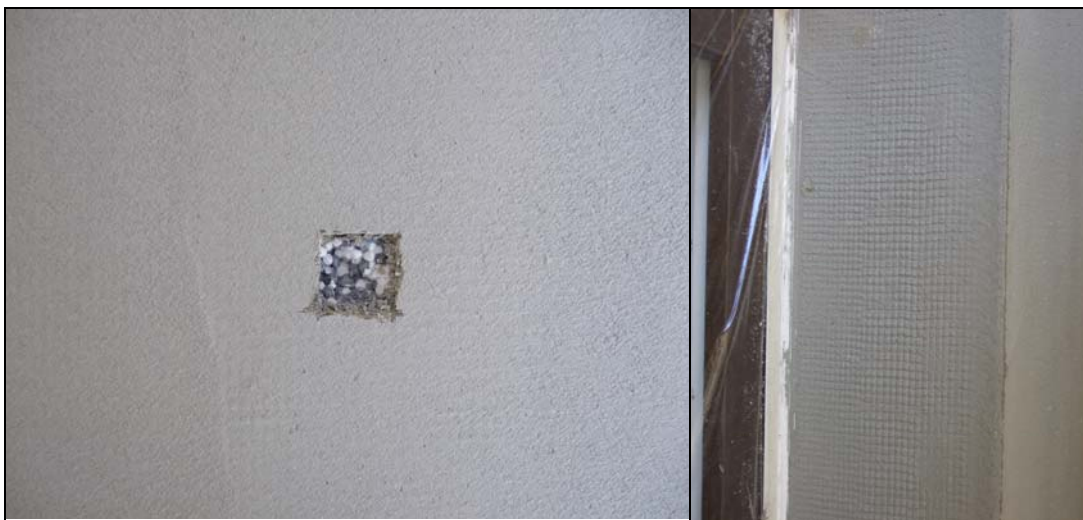
Abb. 20: links: Probeöffnung für Messung der Schichtstärke des Unterputzes rechts: Textilgitter zeichnet sich aufgrund zu geringer Unterputzschichtstärke ab
