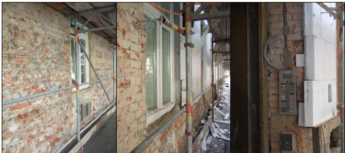
Abb. 3: links und Mitte: unverputztes Mauerwerk (Putz abgeschlagen) rechts: Fehlstellen nicht mit Mörtel ausgeglichen
