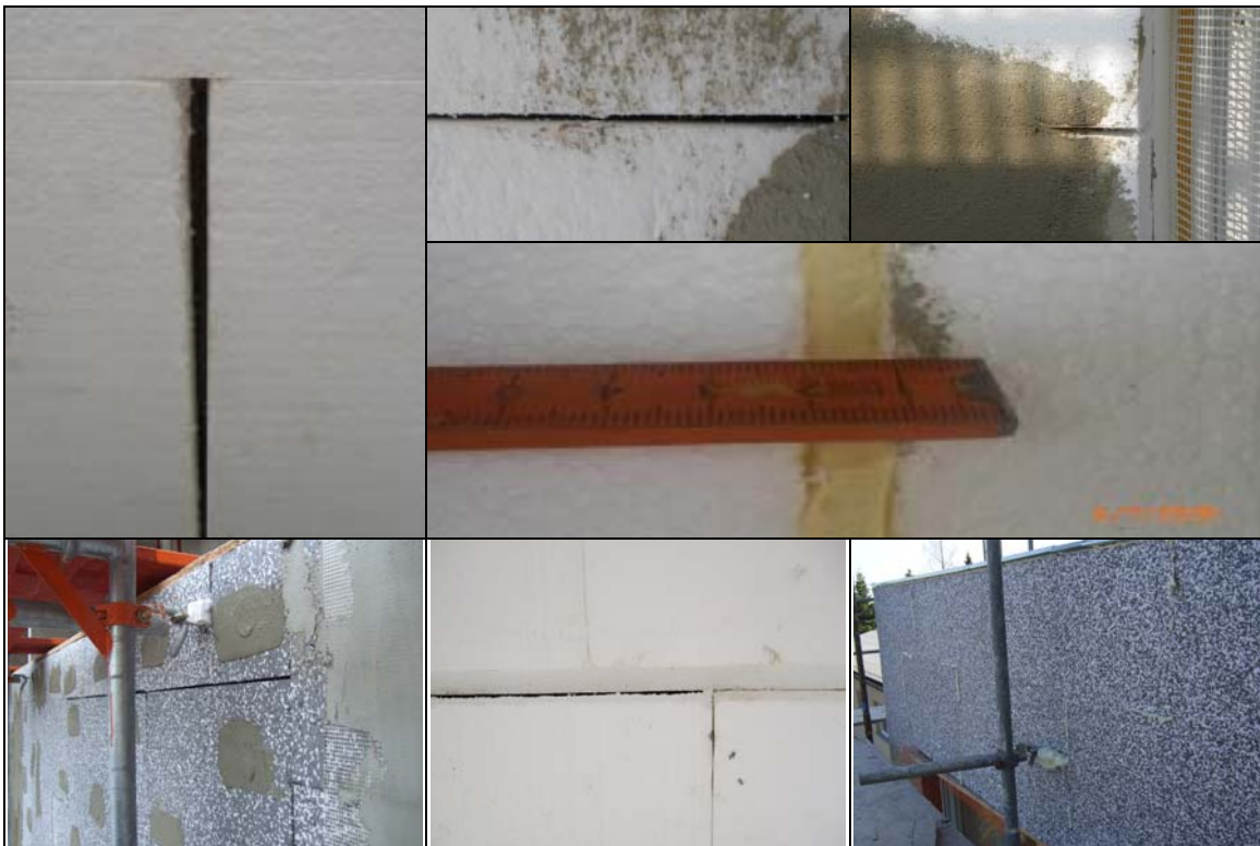
Abb. 15: Fugen zu groß bzw. nicht ausgeschäumt; unten rechts: Fugen ausgeschäumt
