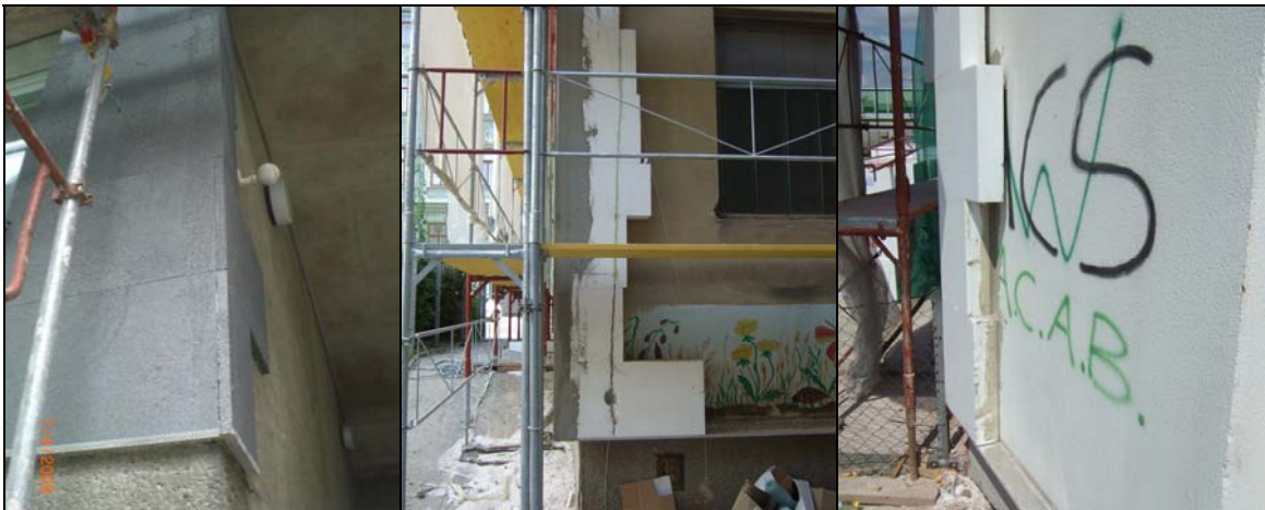
Abb. 11: nicht normgemäße Ausbildung von Gebäude-Außenkanten
