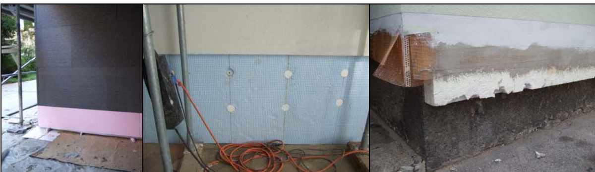
Abb. 9: links: Sockelausbildung mit unterem Sockelprofil; Mitte: Sockelausbildung ohne unterem Sockelprofil; rechts: nicht normgemäße Sockelausbildung.
