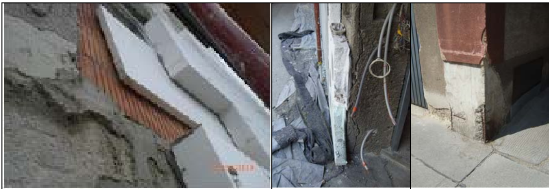
Abb. 1: links: Putzfehlstellen wurden nicht geeignetem Mörtel ausgeglichen; Mitte: loser Grobputz nicht entfernt; rechts: lose Teile entfernt
