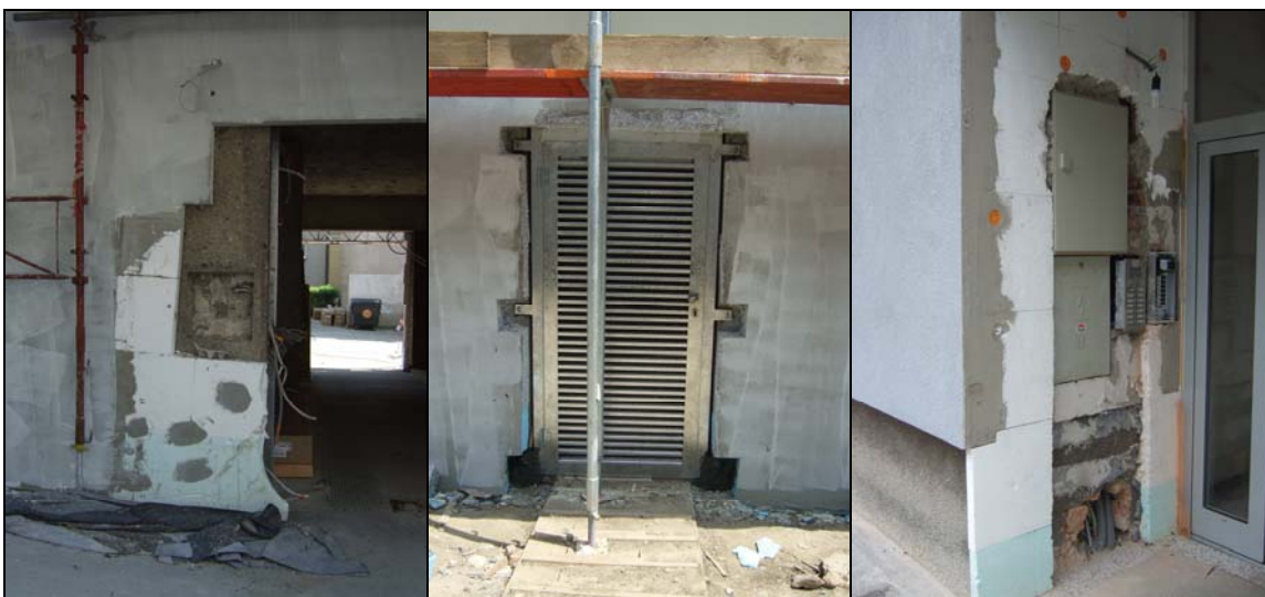
Abb. 5: links: fehlende Metallkonstruktion für Anschlussherstellung Mitte: Einbau Türzarge nach dem Verlegen der Dämmplatten rechts: Elektroarbeiten noch nicht fertig gestellt
