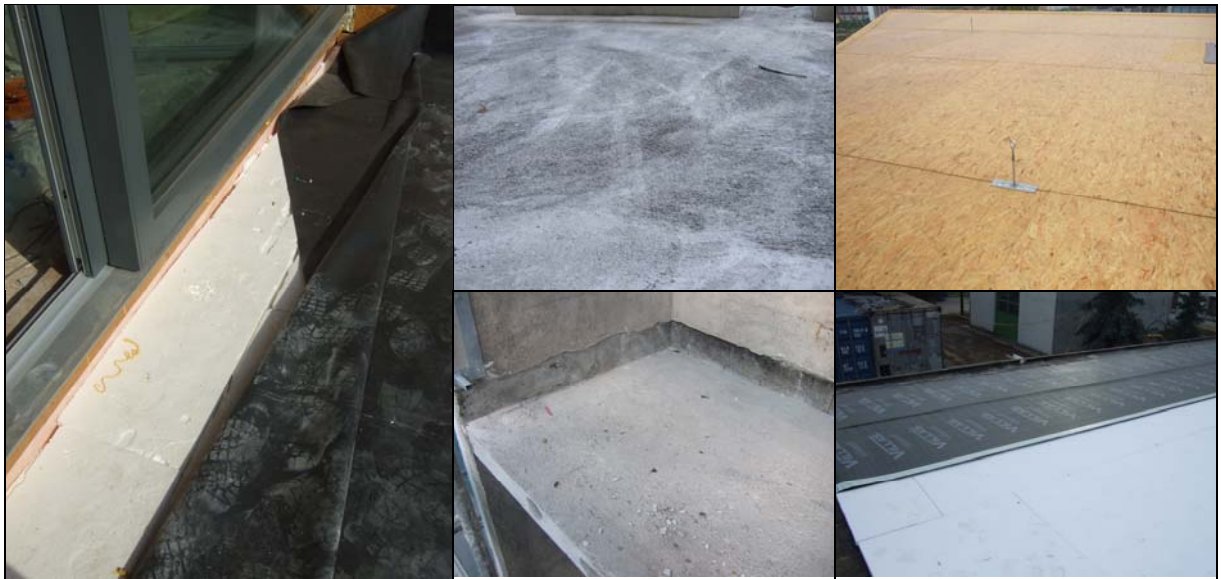
Abbildung 12: Untergründe für Abdichtungen; links: nicht ausreichend druckfeste Wärmedämmung; oben Mitte: zu raue Betonoberfläche; oben rechts: Holzuntergrund; unten Mitte: Betonoberfläche; unten rechts: Wärmedämmung.
