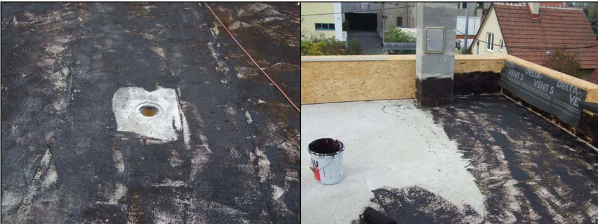
Abbildung 13: Voranstriche, teilweise nicht flächendeckend aufgebracht
