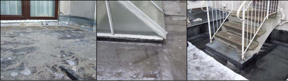
Abbildung 26: Bild links und Mitte: Hochzugshöhen vor allem im Türbereich bzw. bei Lichtkuppel für die Anordnung von (stärkeren) Dämmschichten nicht ausreichend. Bild rechts Einbindung einer Stiege in die Abdichtung mit Flüssigkeitsabdichtung.
