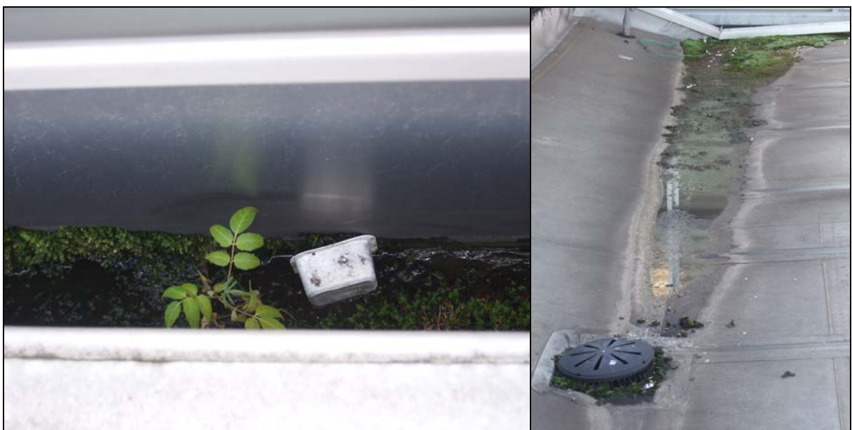
Abbildung 29: unzureichend gewartete Rinne bzw. Flachdach
