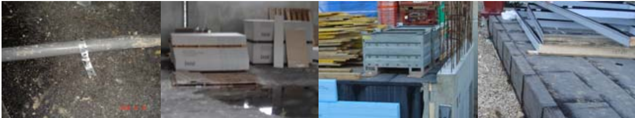
Abbildung 17: Leitungsführung direkt auf der Abdichtung, Lagerung von Baumaterialien auf der fertig gestellten Abdichtung
