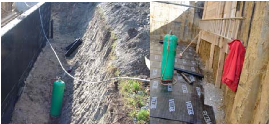
Abbildung 24: Flämmarbeiten ohne bereitgestellten Feuerlöscher
