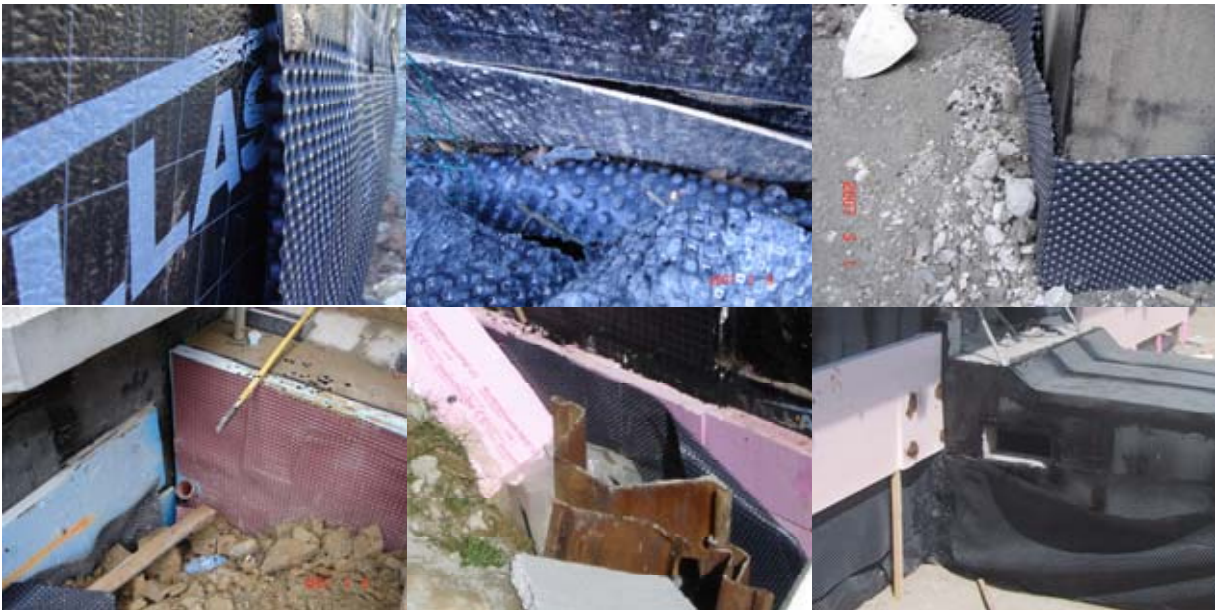
Abbildung 15: Fehler bei der Verlegung von Noppenbahnen
