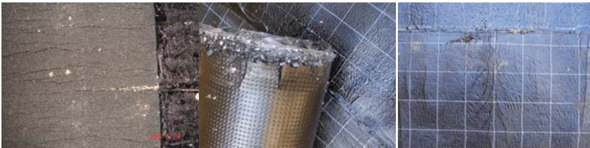
Abbildung 20: Bild links: „gebrochene“ Abdichtungsbahn mit Glasvlieseinlage Bild Mitte und rechts: „gebrochene“ Plastomerbitumenbahnen
