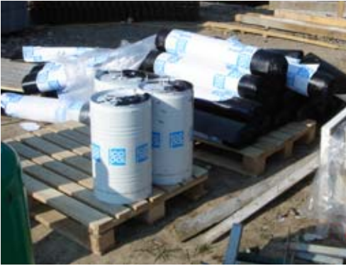
Abbildung 21: falsche Lagerung des Materials
