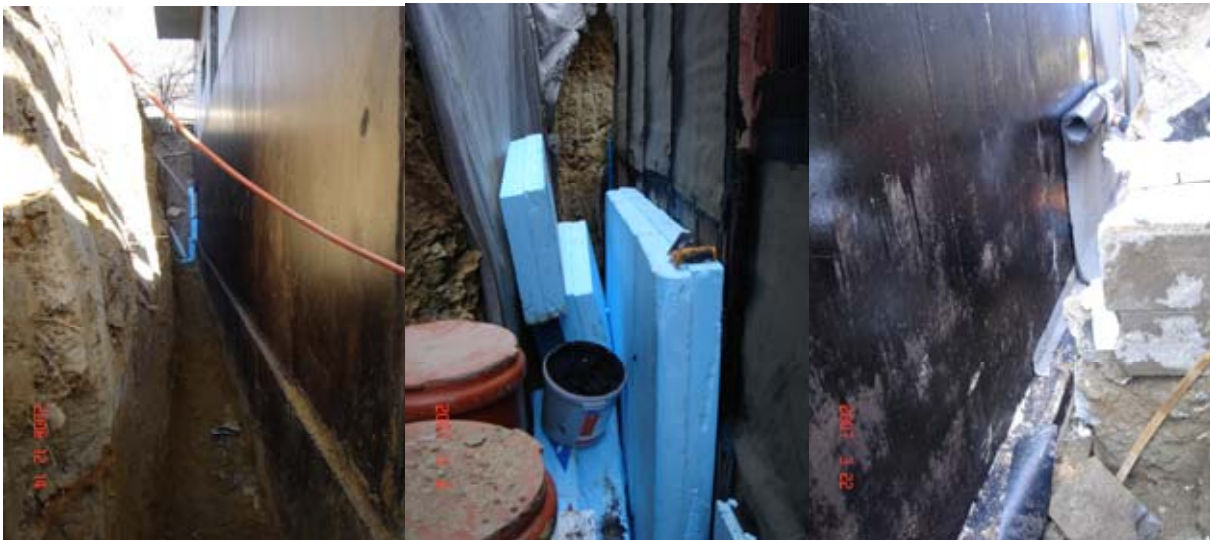
Abbildung 8: zu enger Arbeitsraum
