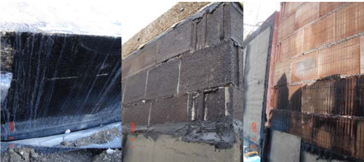
Abbildung 11: Bild links: zu glatte Betonoberfläche, Abdichtung abgerutscht Bild mitte und rechts: Fugenausbildung und Ebenheit der Wandoberflächen nicht normgemäß.
